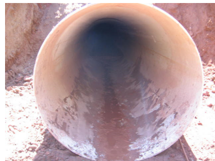
Tuberías de Fibra de Vidrio instaladas con un grado de deterioro grande, lo cual pondrá en peligro la vida de los Chorreranos
